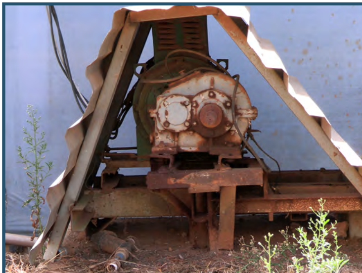
LOTE M08 – GERADOR 30KVA – MARCA BAMBOZZI
